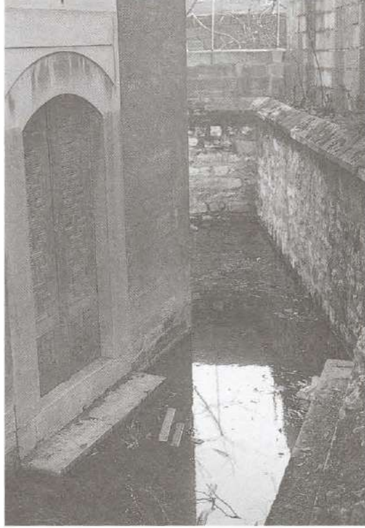
27. Eyüp'te Şair Fitnat Hanım Türbesi çevresinin yağmur sonrası durumu
