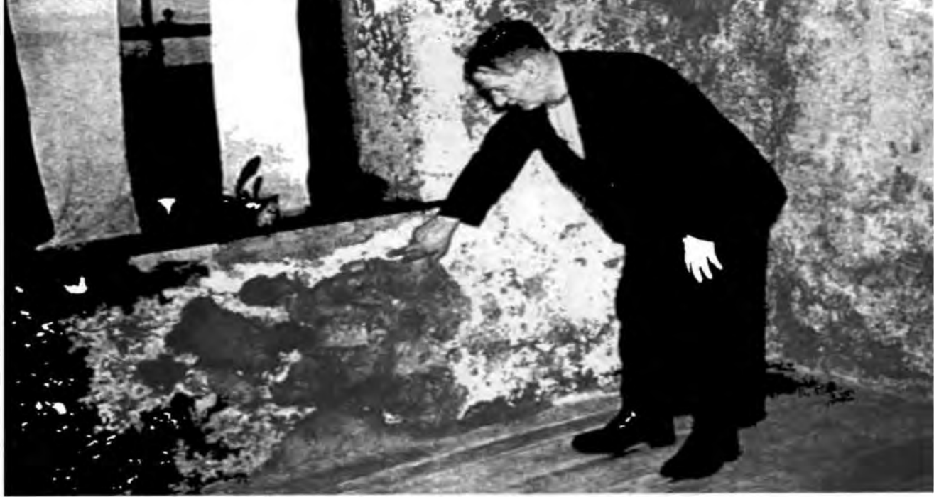
Blaina, Wales: Varoř kulübesinin çürüyen duvarları.
