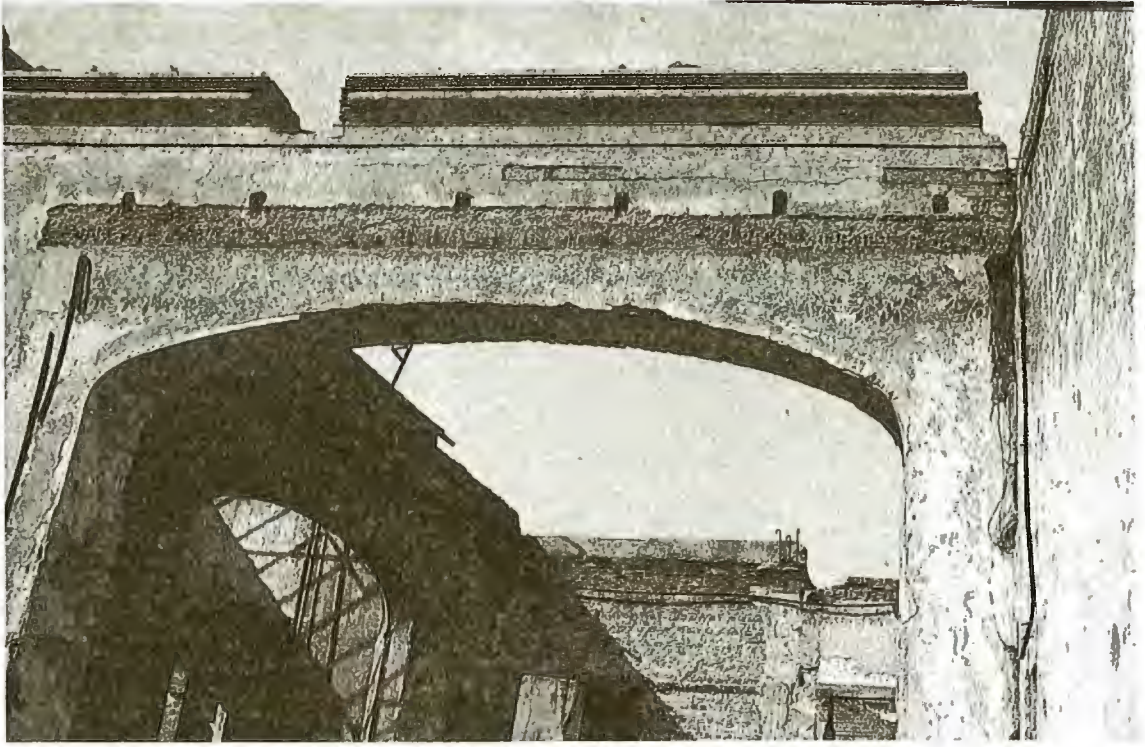
18. İkinci katta yangın sonrası açığa çıkan saçak profili (1979).
