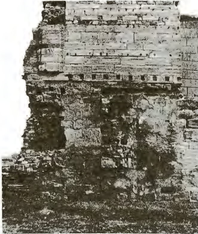
Resim 6 - Cihannüma Kasrında yan kanat duvarlarına ait yırtılma izleri.
