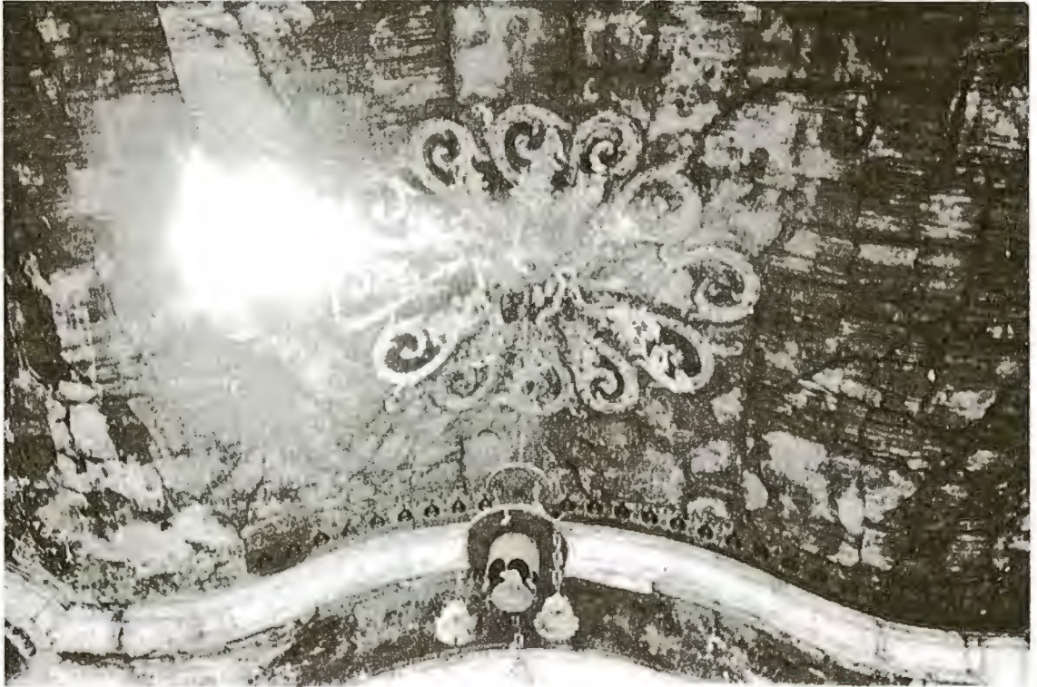
6. Toplantı Salonu merdiven holü tavanının yangın sonrasındaki durumu (İstanbul 1 Numaralı Kültür ve Tabiat Varlıklarını Koruma Kurulu Arşivi, 1978).
