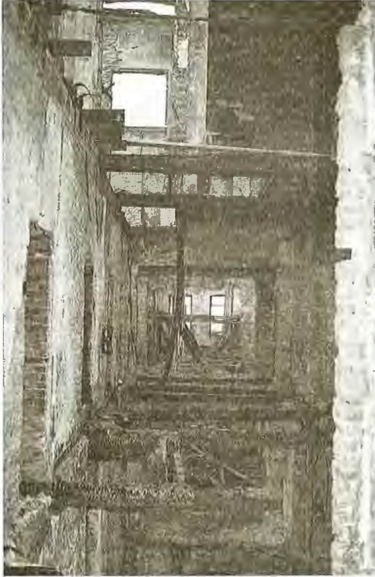
3. Yangın sonrasında ana binanın orta kat koridorundan bir görünüş (İstanbul 1 Numaralı Kültür ve Tabiat Varlıklarını Koruma Kurulu Arşivi, 1978).
