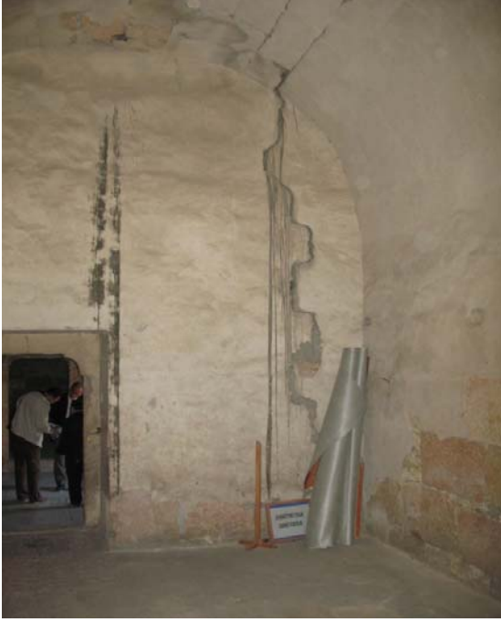
Fotoğraf-11: Dâr-üş Şifâ duvarlarında yer yer çatlaklar oluşmuştur
