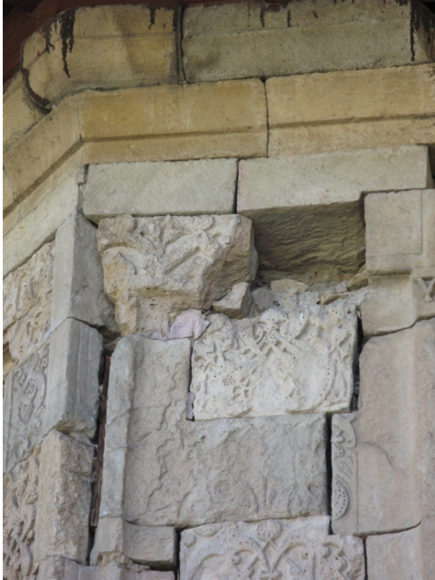
Fotoğraf-7: Deprem sonucu Ulu Camii'nin batı kapısından taşın düştüğü bölüm
