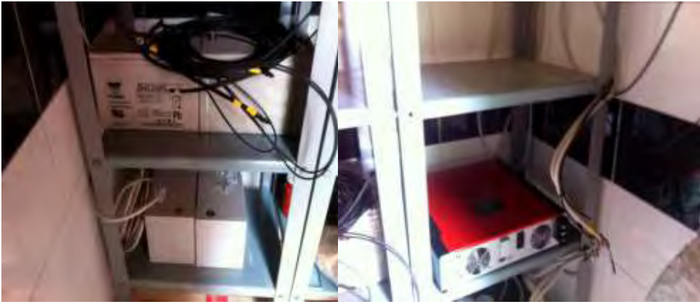
Şekil 10: Akü Kümesi ve Eviricinin Test Merkezinde Kurulumu.
