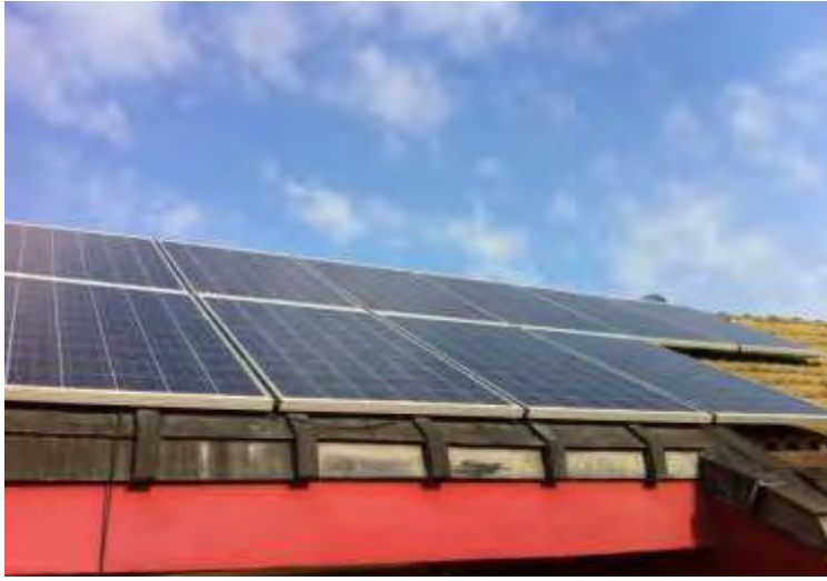
Şekil 8: Montajı Tamamlanmış Fotovoltaik Güneş Panelleri.
