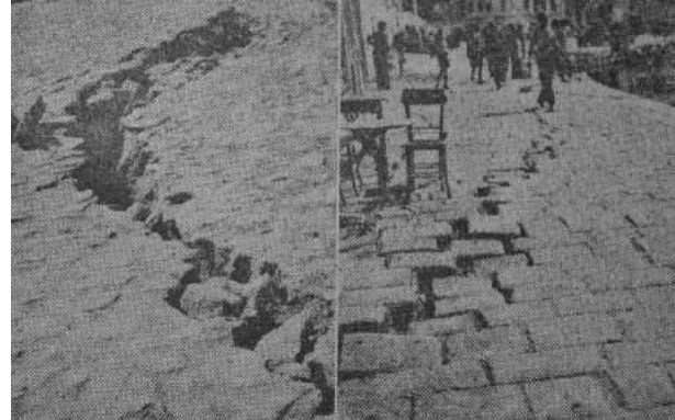
Ayvalık'ta çatlayan yollar
