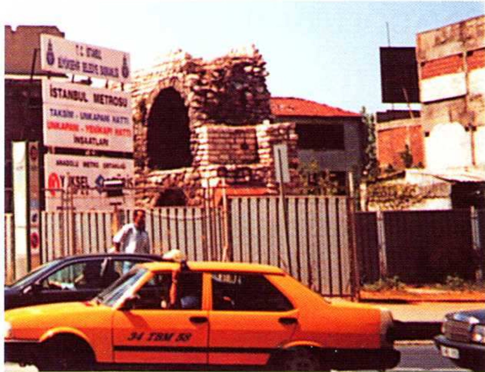
İstanbul, Süleymaniye Küçükpazar semti. Kaçak otoparkın belediye tarafından yıkılan kısmı (solda). Karaköy-Azapkapı'da antik yapının hemen yanına kurulan metro şantiyesi.
