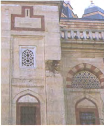
Selimiye Camii üzerinde Bulgar gülleleri tarafından meydana getirilmiş top yıkığı.
