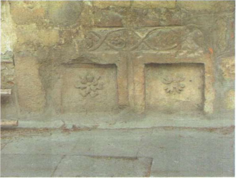
Resim 145. Seydişehir. Seyyid Harun Câmii duvarları dış yüzünde Roma ve Bizans çağı yapılarının kalıntılarından devşirilme taşlardan birkaçı.
