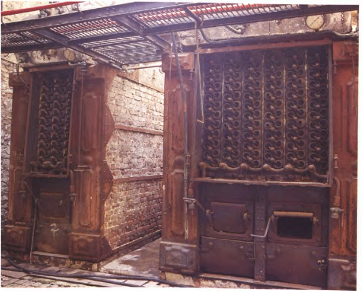
5 Dolmabahçe Sarayı kalorifer kazanları.
