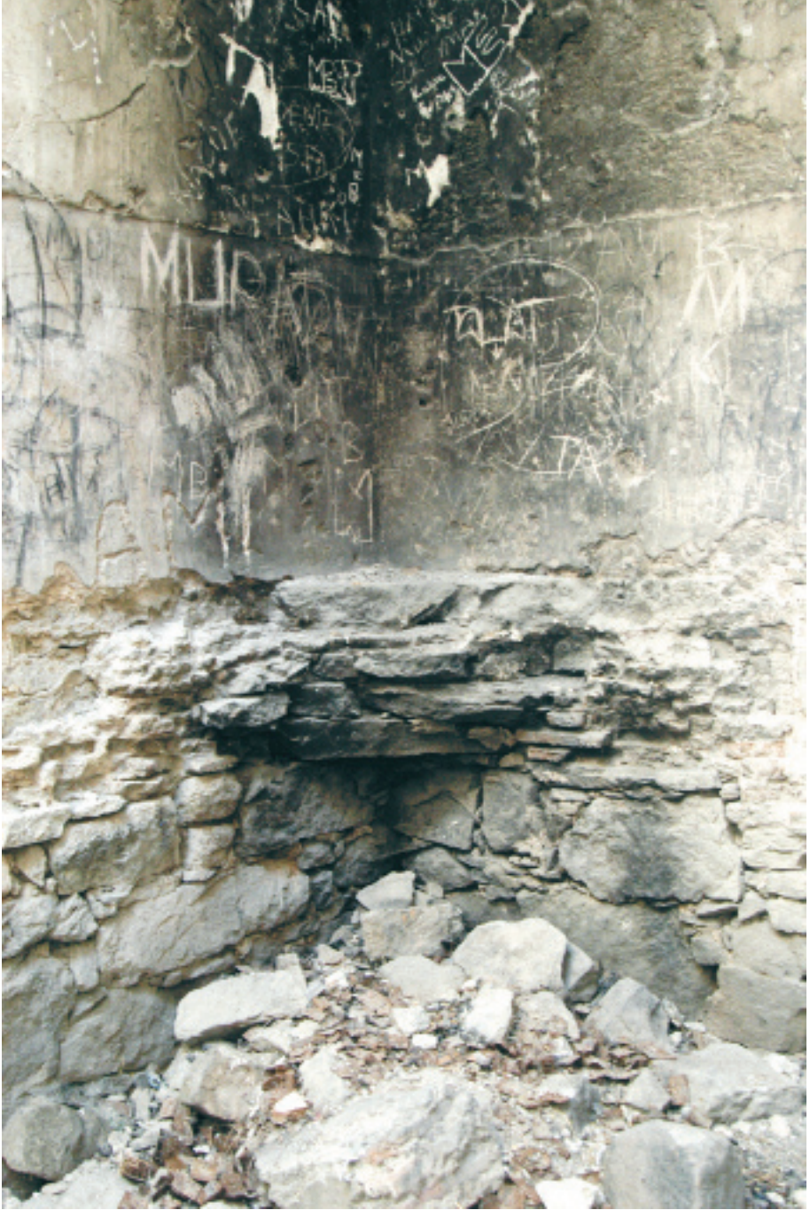
Sivrihisar Gavur Hamamı Sıcaklık Bölümü Tahrip Olmuş Zemin Döşemesi Kalıntısı (A.Gerengi-2008)
