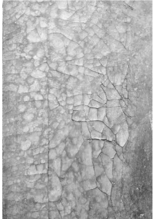
Resim 7: Eskime çatlağı detay çekim
