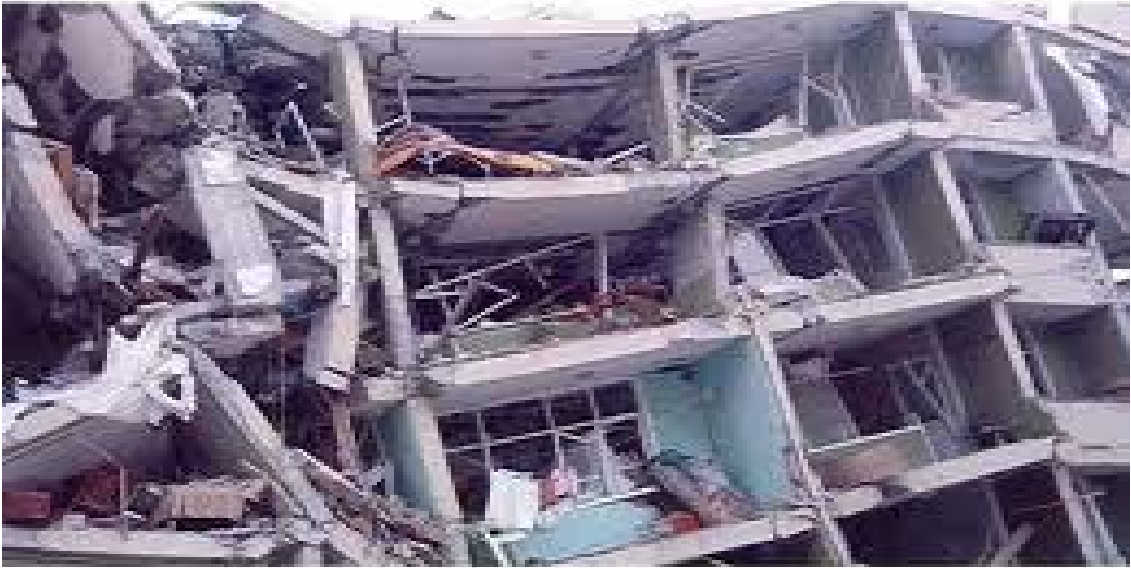
Foto 1: Depreme Bağlı Olarak Meydana Gelen Tahribat
