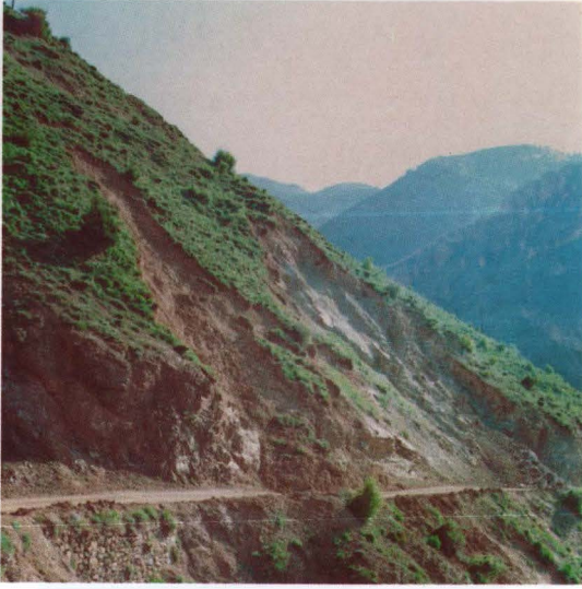
Foto 8 — İncirli Mahallesi yakınlarında karayolu çalışmaları sırasında oluşan heyalanlar.
