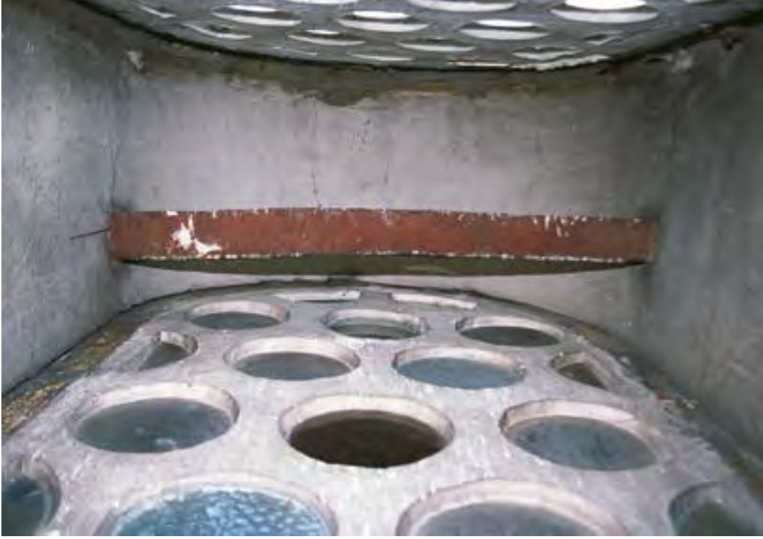
Fotoğraf 8: Süleymaniye Camii kubbe kasnağı pencereleri üzeni hizasında bulunan demir gergi
