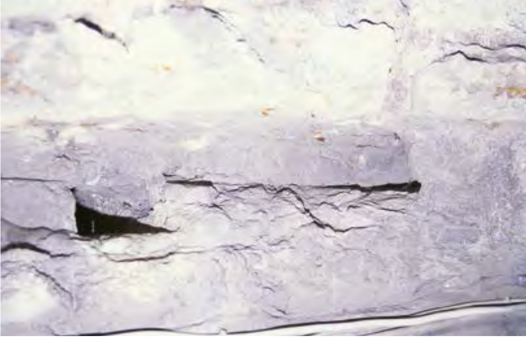
Fotoğraf 1: İmaret, duvar örgüsünde ahşap ızgara sistemi (ahşabı yok olmuş)
