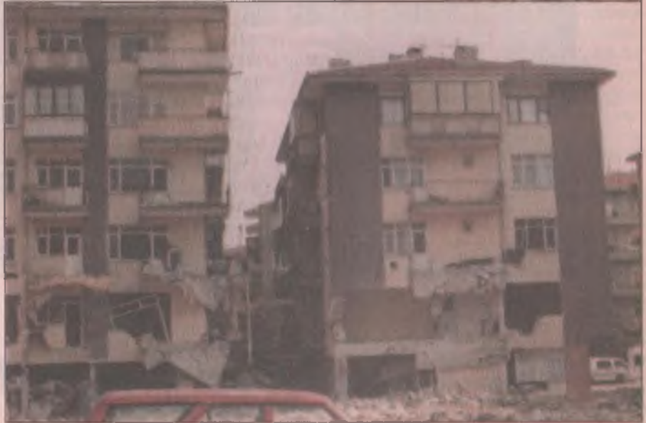
Yapıdan "konsol" olarak dışarıya taşan (balkon) döşemelerde demir yetersizlikleri görülmektedir.
