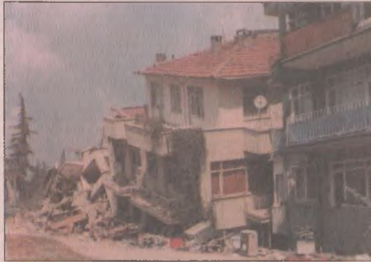
Yan yana yapılar. Bazıları tamamen yıkılmış, bazıları da şöyle ya da böyle ayakta. O halde yıkılarda, yıkılmayana göre bir sorun, bir kalitesizlik, bir hata, bir ihmal var.
