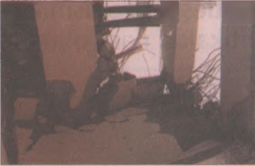
Özellikle deprem bölgelerinde hervürlü çelik kullanılması gerekirken, fotoğraftaki yapıda düz demir kullanılmış. Buna rağmen "Bina bu nedenle yıkılmıştır" denemez.
