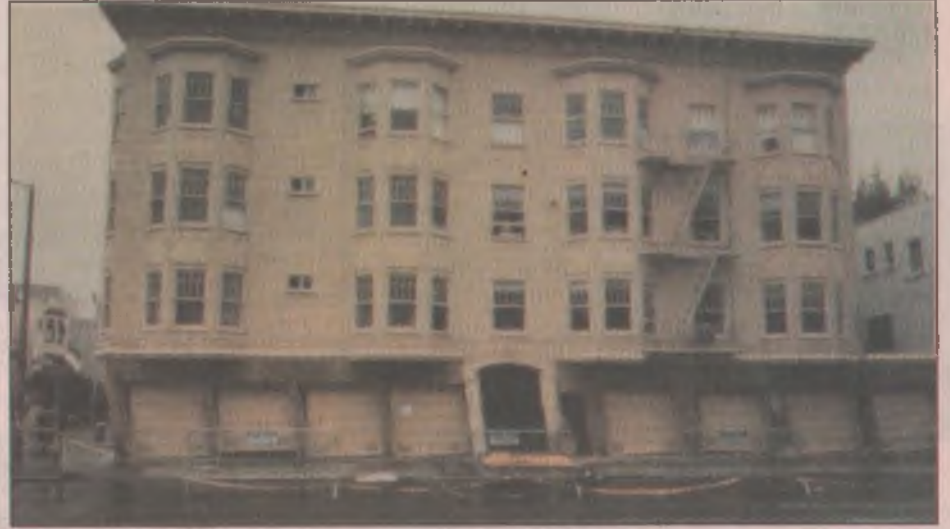
San Fransisko Marina bölgesinde “tehlike katı” hasarı (17 Ekim 1989 Loma Prieta-Kaliforniya Depremi, M = 7.1).
