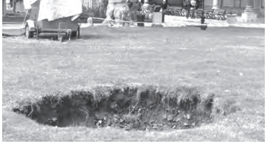
Topkapı Sarayı bahçesinde meydana gelen göçük.
