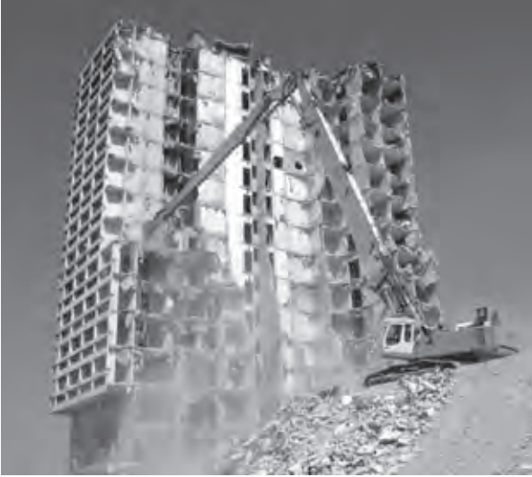
Asbestten arındırılmadan yıkımı yapılan bir bina.
